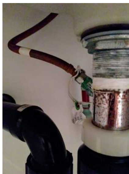
Tuyau flexible et drain rouillés à cause de l'entreposage sous l'évier de produits nettoyants biologiques et d'engrais pour plantes et gazon.
